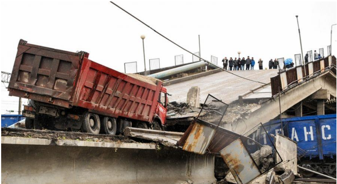
Рисунок 1. Обрушение пролетного строения автодорожного моста при проезде большегрузного транспортного средства в Амурской области.
