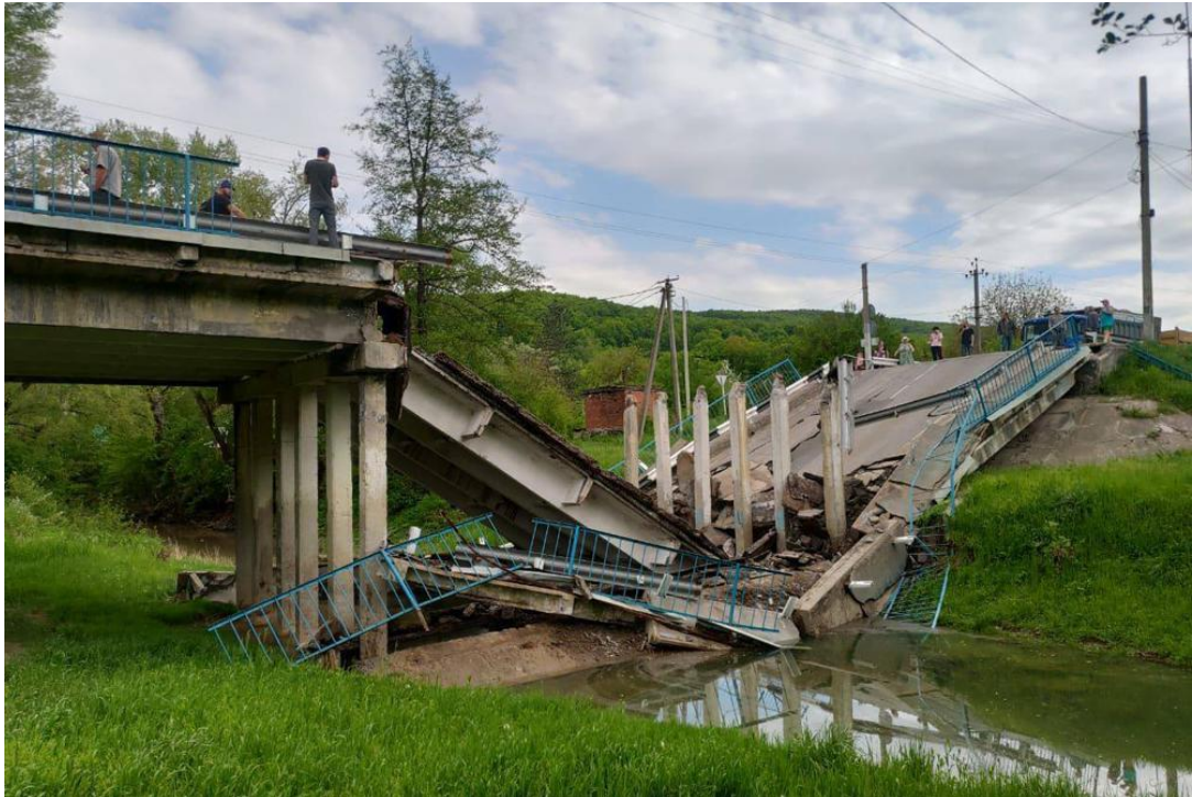
Рисунок 2. Обрушение пролетного строения автодорожного моста при проезде большегрузного транспортного средства в Краснодарском крае
