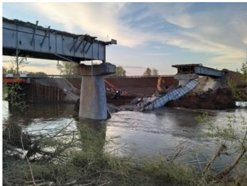
Рисунок 3. Обрушение пролетного строения автодорожного моста при проезде большегрузного транспортного средства в Оренбургской области
